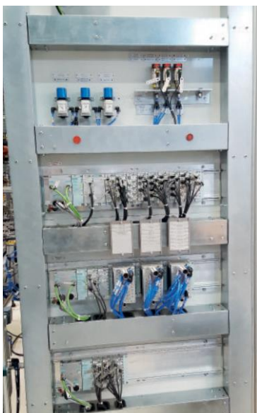
>> Installationsbeispiel einer Messanlage
